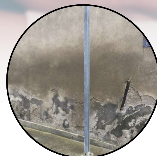
Linha de umidade
