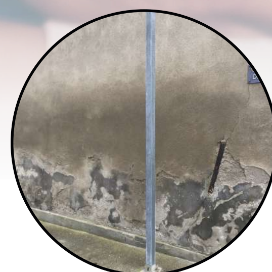
Linha de umidade
